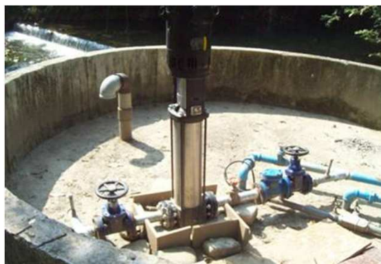
EQUIPAMIENTO EN EL CÁRCAMO DE HUEXOTITLA
